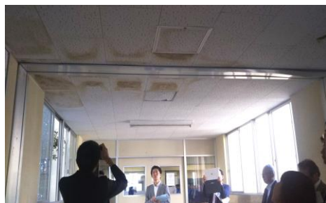
太東中の雨漏り痕
